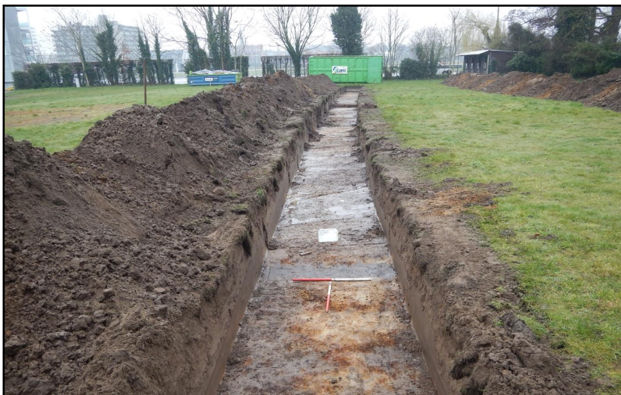
Figuur 6: Sleuf 3 diende in het noordwesten wat ingekort te worden wegens de aanwezigheid van een container op het terrein.
