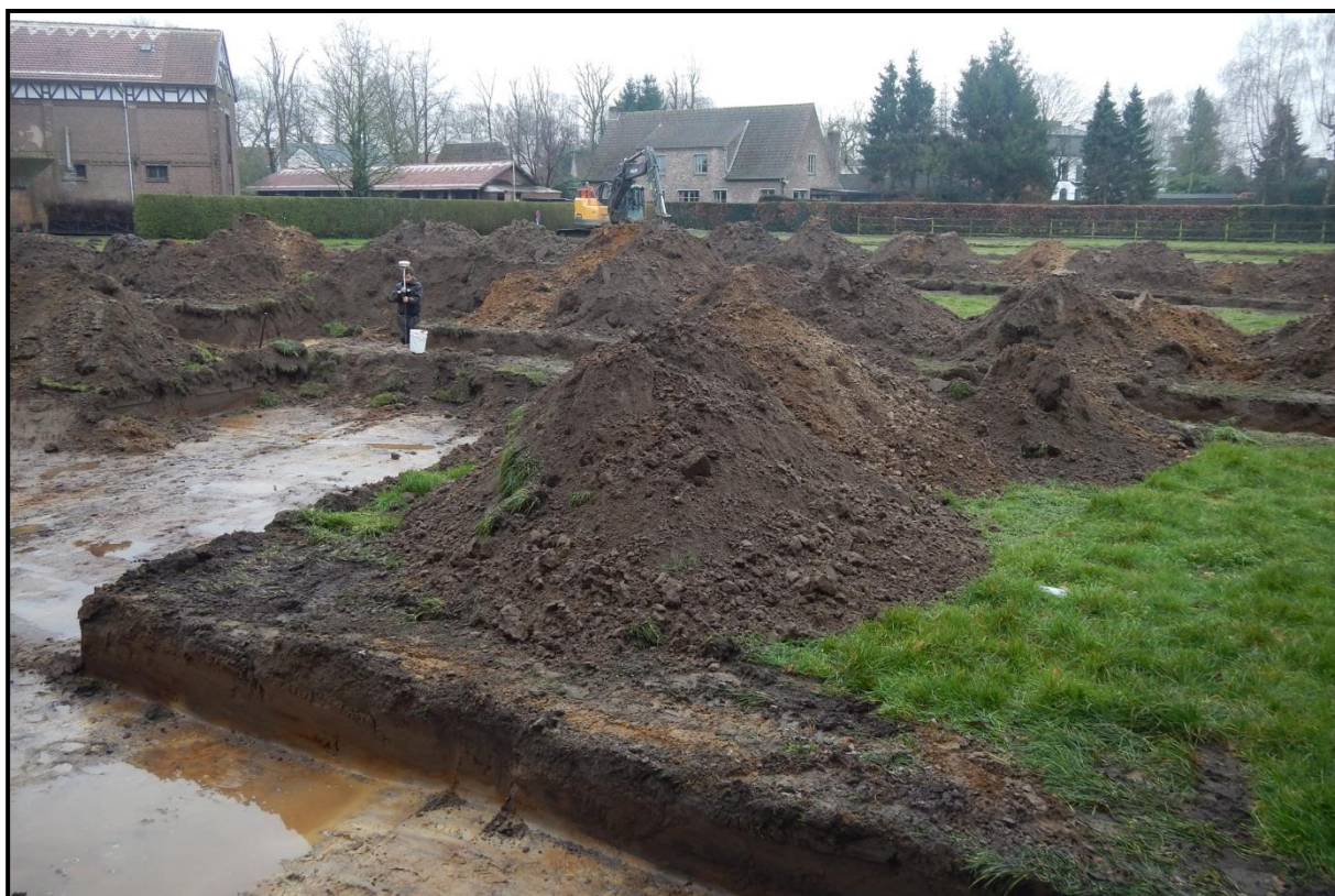
Figuur 7: Zicht vanuit het noorden op de aangelegde sleuven. Na het uitgraven kwamen de sleuven al snel deels onder water te staan (grondwater). Sleuven 4 en 5 werden reeds gedicht.
