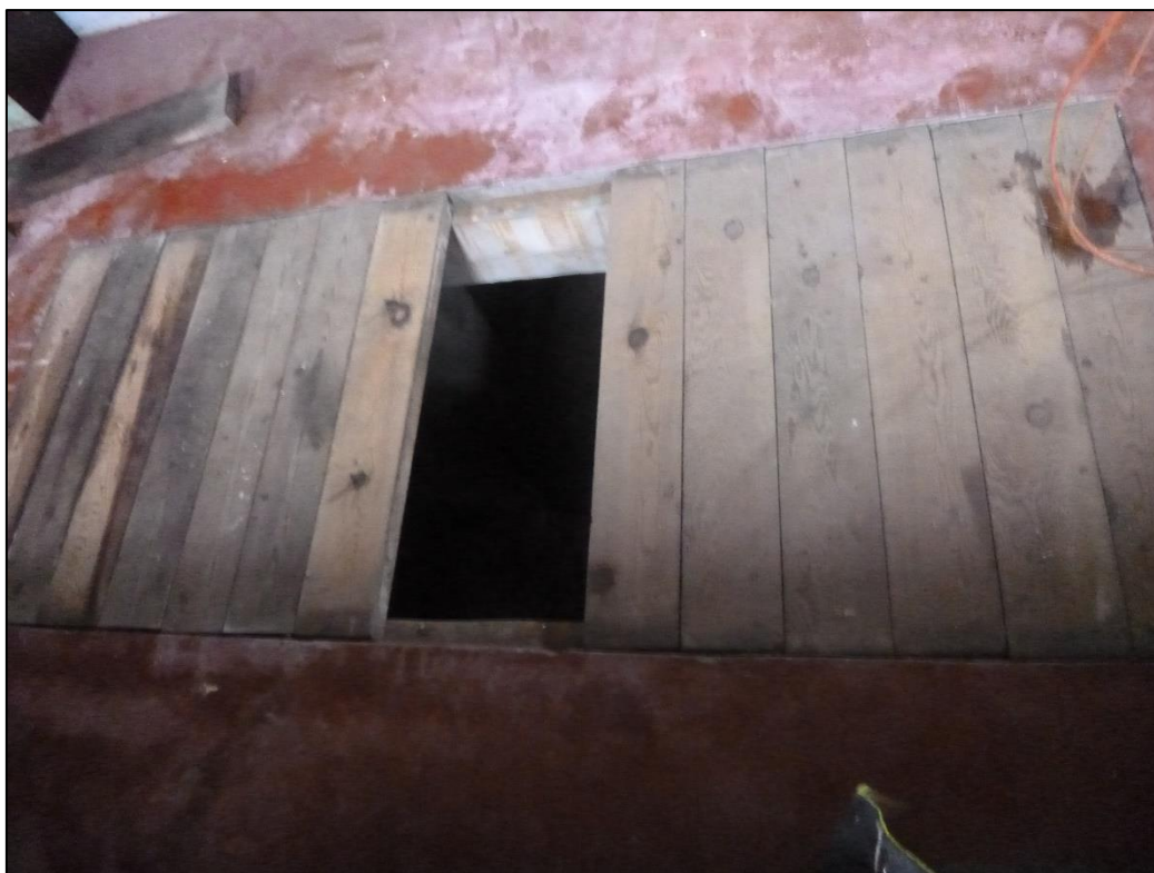
Figuur 4: Smeerput in de garage van huis nr. 11A (ABO nv)
