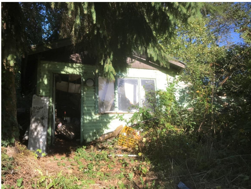
Figuur 4: Zicht op de ingestorte schuur/'koterij'. 6
