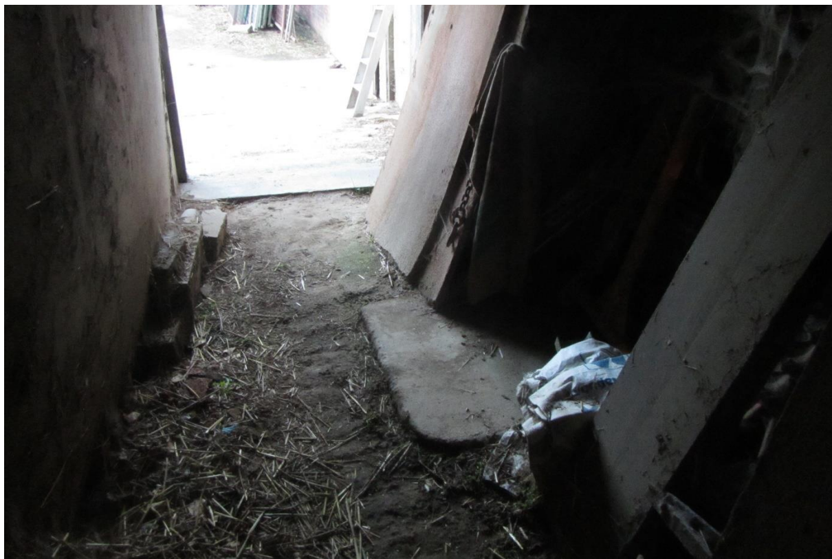
Figuur 8: Deksel van een septische put in de schuur (nummer 2 op figuur 6).
