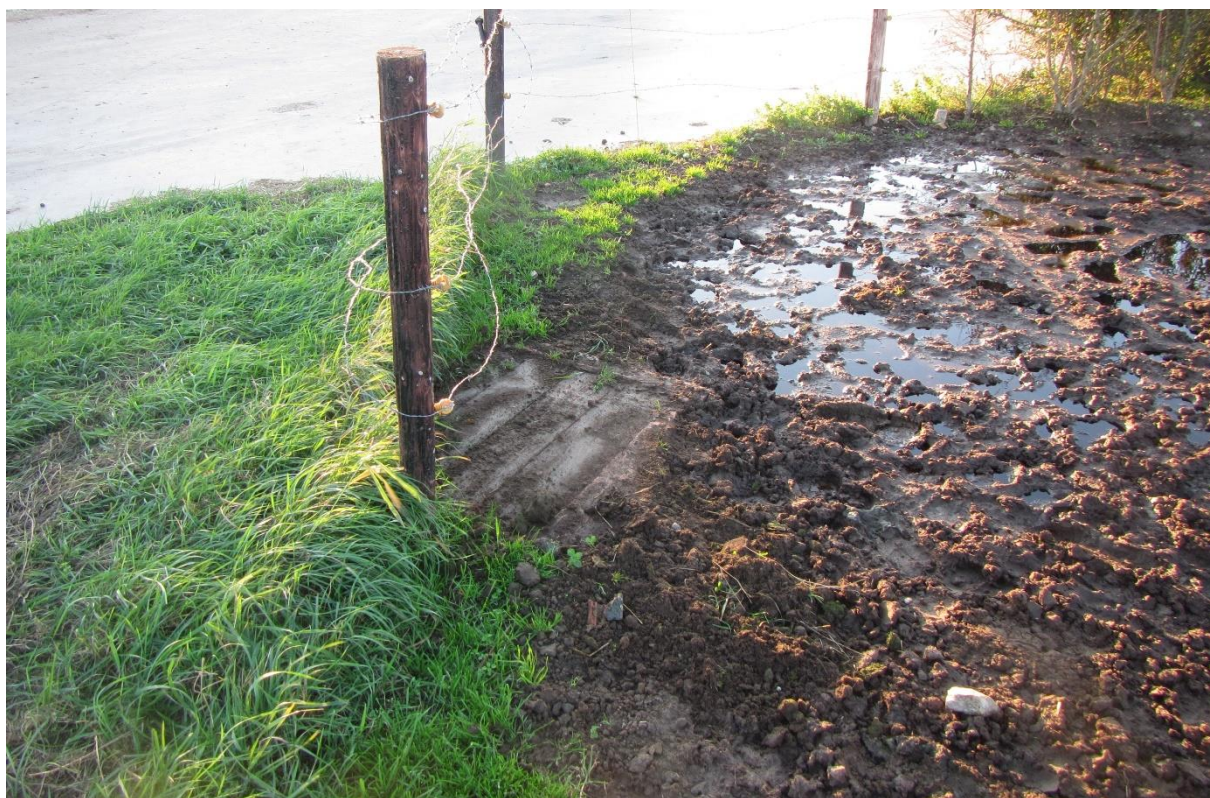
Figuur 12: Mangat en toegang tot de centrale septische tank.
