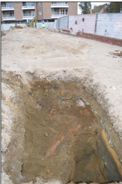
Afb. 14: Detailfoto PP1 met zicht op de aangesneden nutsleiding (Bron: Aron bvba, dd. 23/10/2018, 2018J260).
