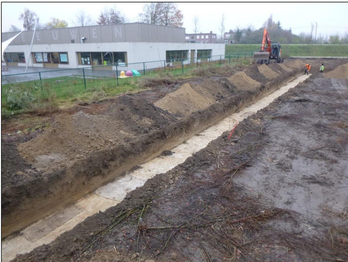
Figuur 10: foto's methodiek – aanleggen van het vlak ter hoogte van westelijke kijkvenster werkput 1(©BAAC)
