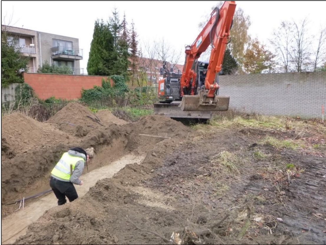
Figuur 9: foto's methodiek – aanleggen van het vlak ter hoogte van werkput 4 (©BAAC)
