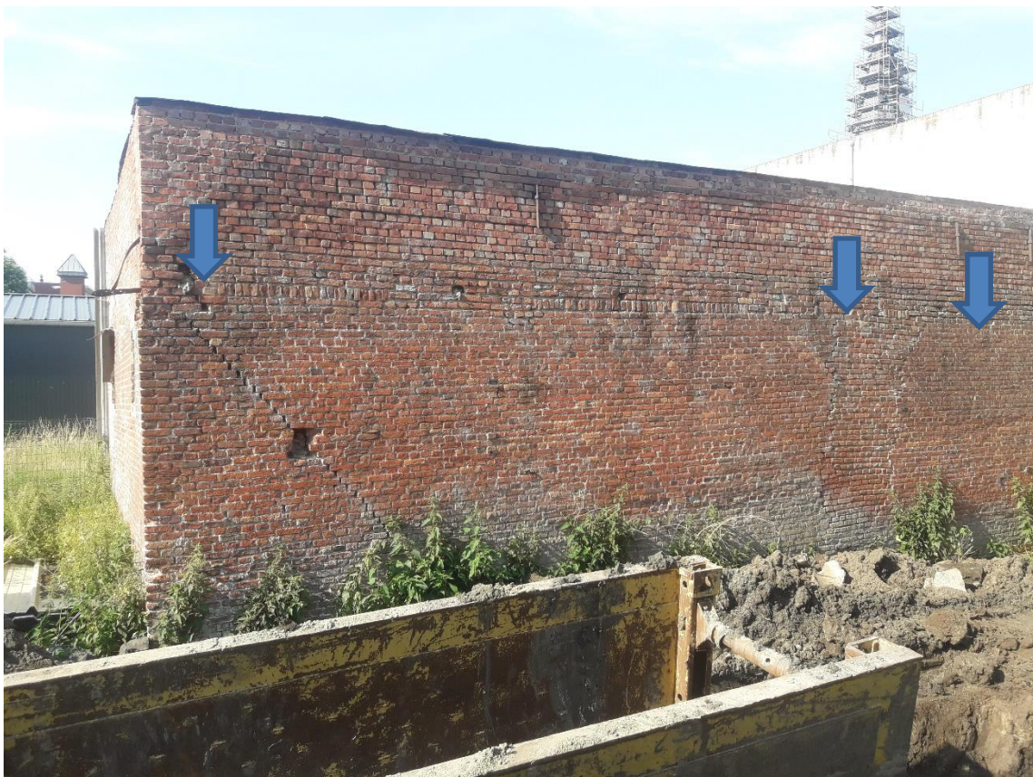
Figuur 8: Detailfoto van de 20e-eeuwse fabrieksgebouwen die bovenop gracht spoor 4 gefundeerd waren. Met blauwe pijlen zijn de barsten in de gevels aangeduid.
