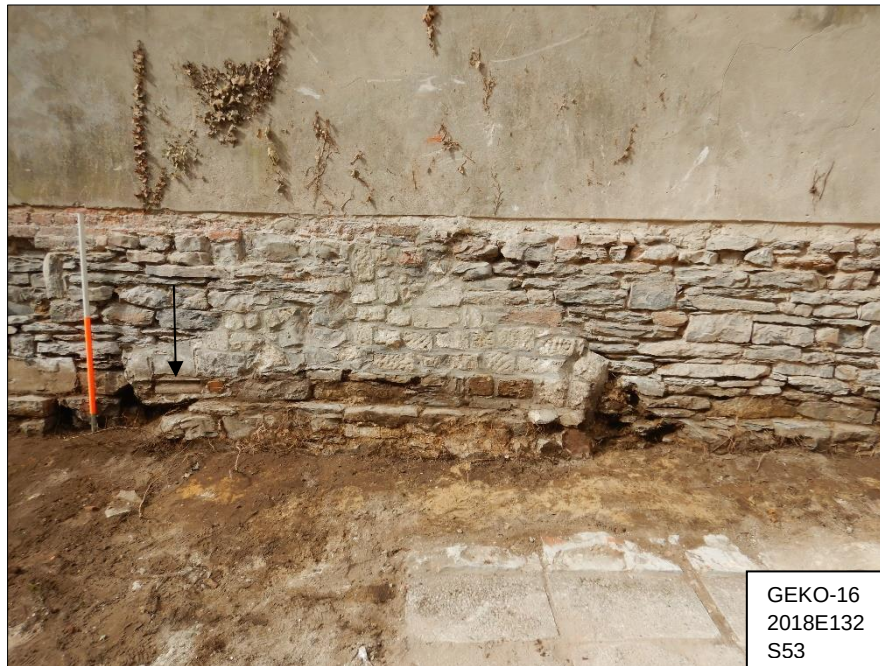
Figuur 87. Boogvormig relict in S53-niveau 1, met aanduiding van de geprofileerde natuursteen
