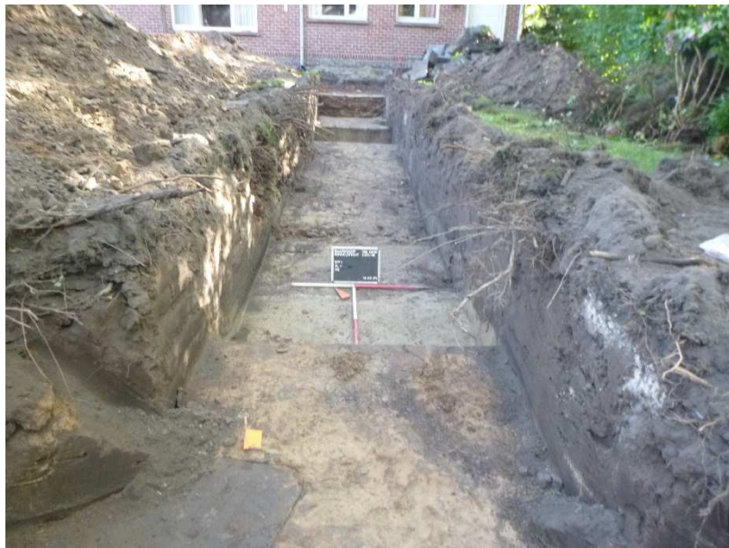
Figuur 21: Vlakfoto werkput 1 met overgang van natuurlijke bodem naar vergraven ondergrond in het noorden. Links onderaan S1002
