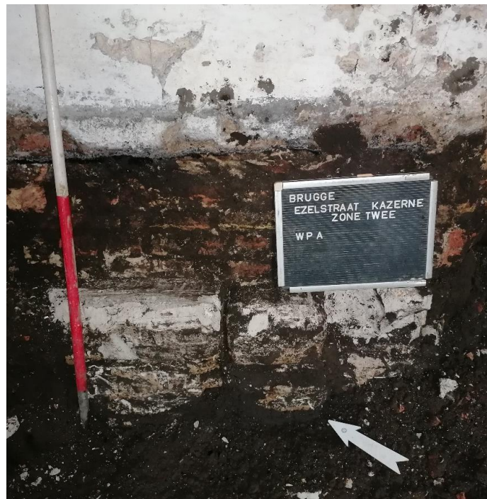
Figuur 10: Fundering onder de baksteen-muur.
