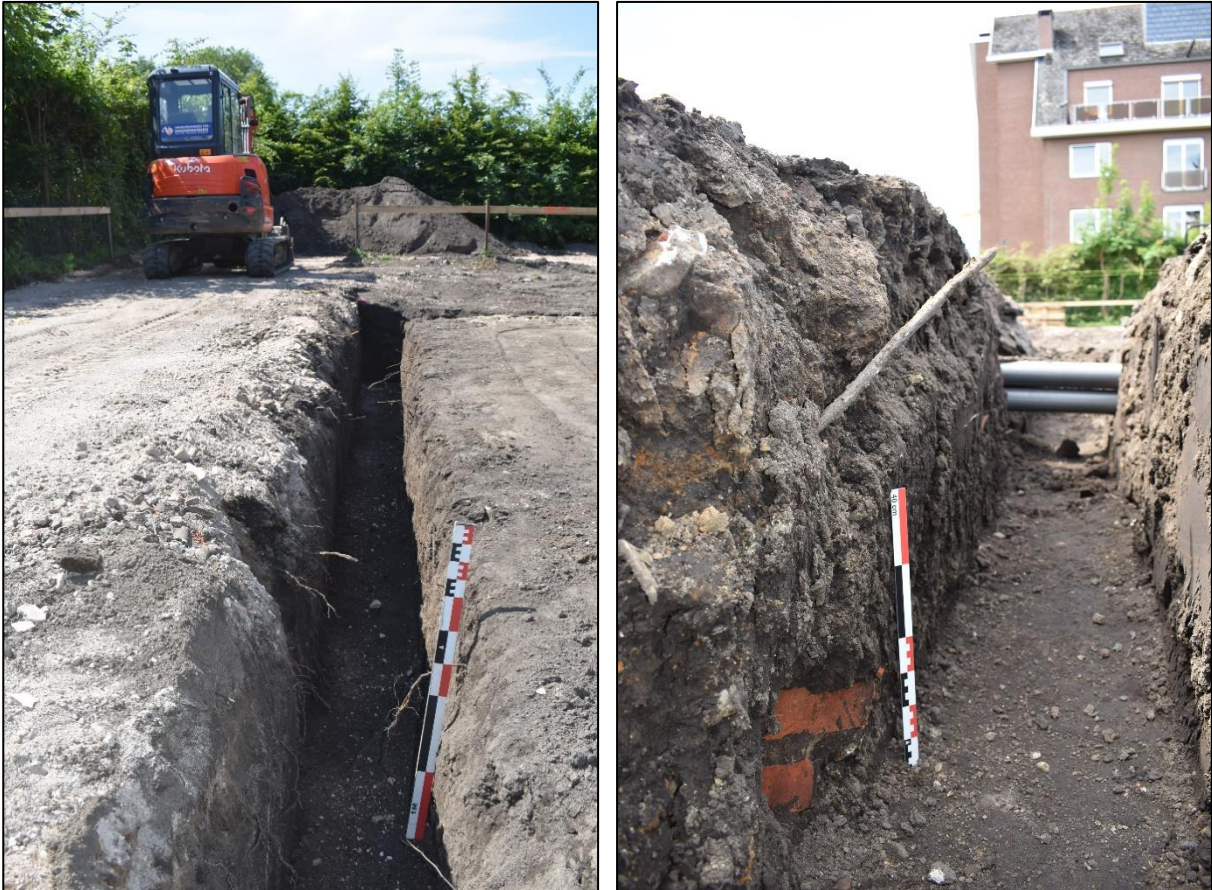
Afb. 6 & 7: Aanleg van de diepere funderingsleuven (ca. 60 cm diep) in de verstoorde bouwvoor (links) en in de bovenzijde van de zwarte laag, die lokaal erg verstoord was door recent bouwpuin (rechts).
