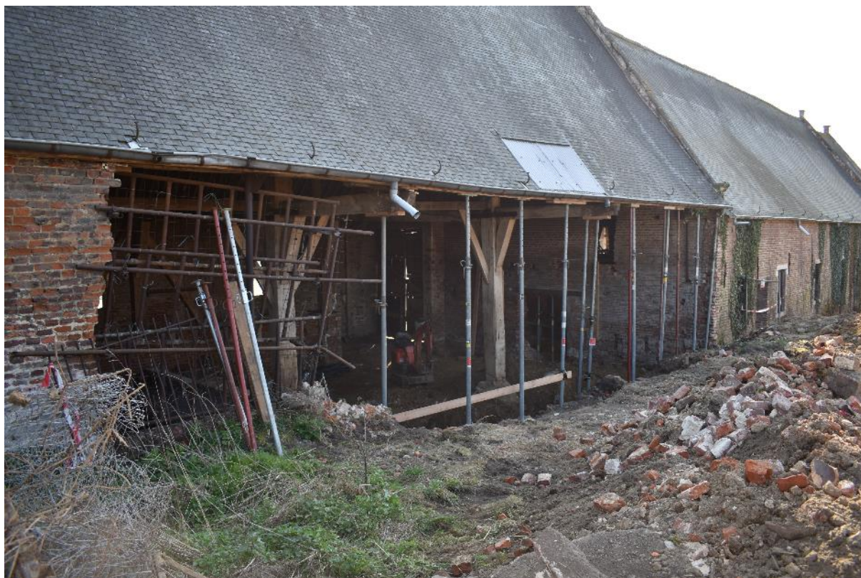
Fig. 1.5: beeld op de deels ingestorte westelijke muur van de Tiendenschuur.
