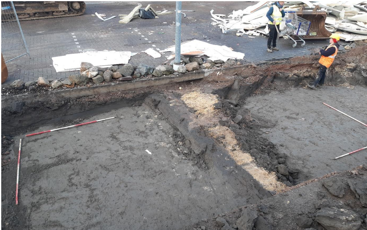
Figuur 7: Detail recente verstoring t.h.v. een lantaarnpaal in het zuiden van de werkput (18.01.2021).
