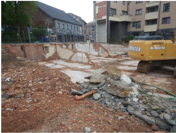
Figuur 22: Zicht op de keldermuren en -vloeren van de gesloopte bewoning langs de Arkenvest
