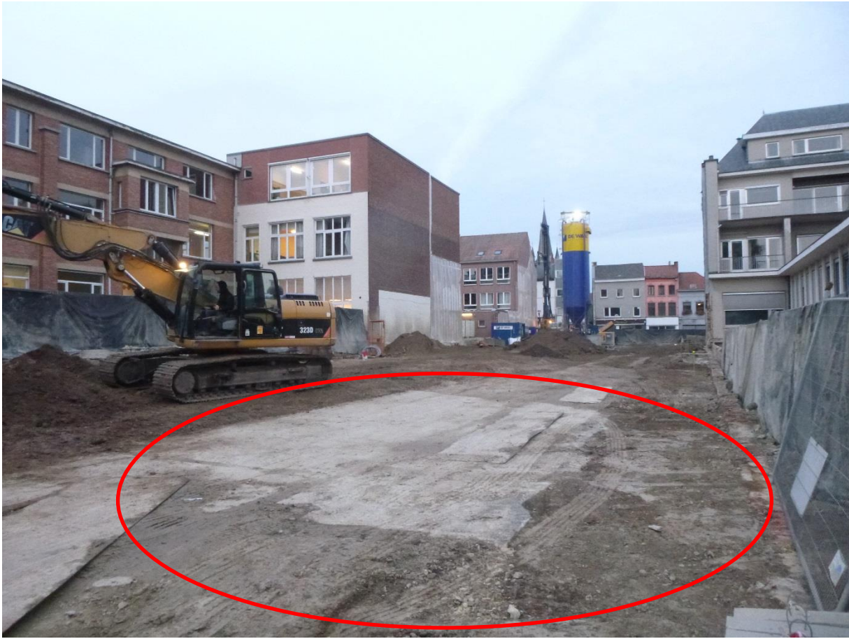
Figuur 9: Terreinfoto genomen vanaf de Oude Vesten richting noordwesten. Vooraan is de teerhoudende asfalt te zien (rood omcirkeld). Deze zone werd niet opgegraven.
