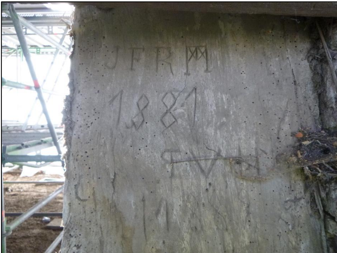
Figuur 29: Inscriptie op één van de gebintstijlen (ABO nv 2020)
