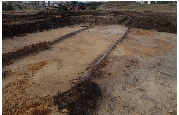
Figuur 146: Recente leidingen in de noordwestelijke hoek
