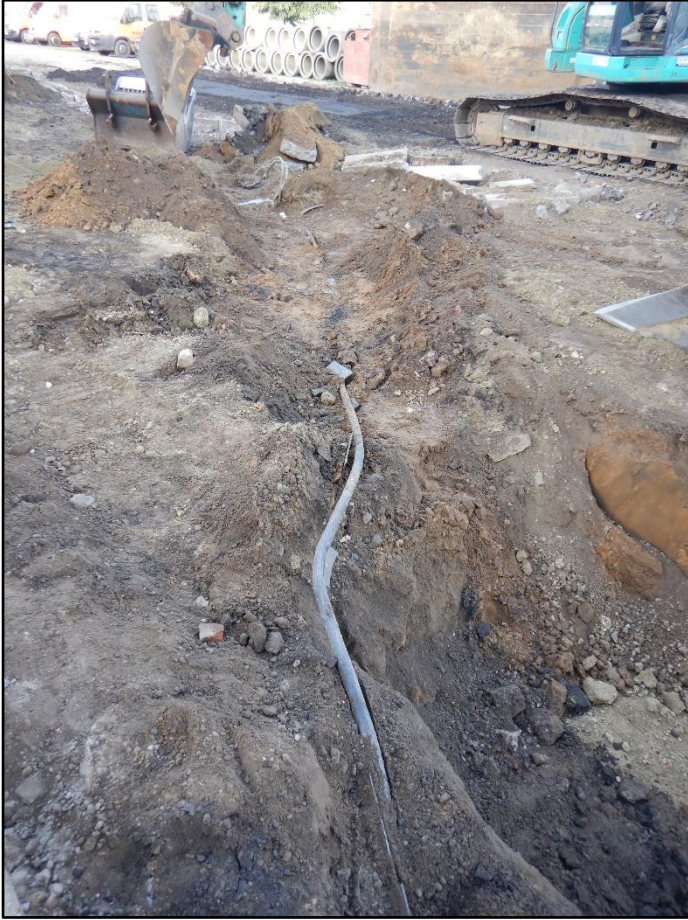
Figuur 13 Diverse werkende nutsleidingen (water, gas, elektriciteit, ...) doorheen het plangebied.
