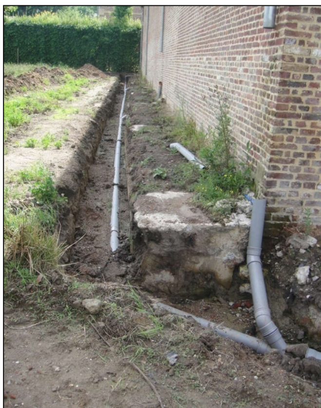
Figuur 10: Buizen langsheen de zuidoostelijke gevel. Foto van vroegere werkzaamheden, aangeleverd door initiatiefnemer 27
