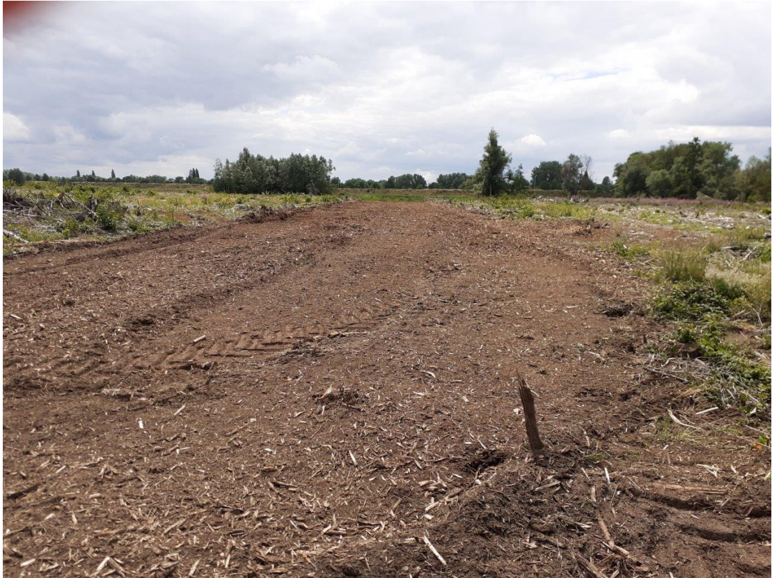
Figuur 10: het oppervlak na het passeren van de bosfrees (foto Stad Gent)
