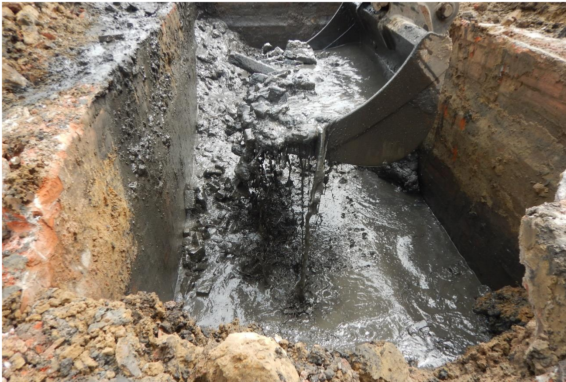
Figuur 9: Kelder van mazouttank met water en verontreinigde grond.
