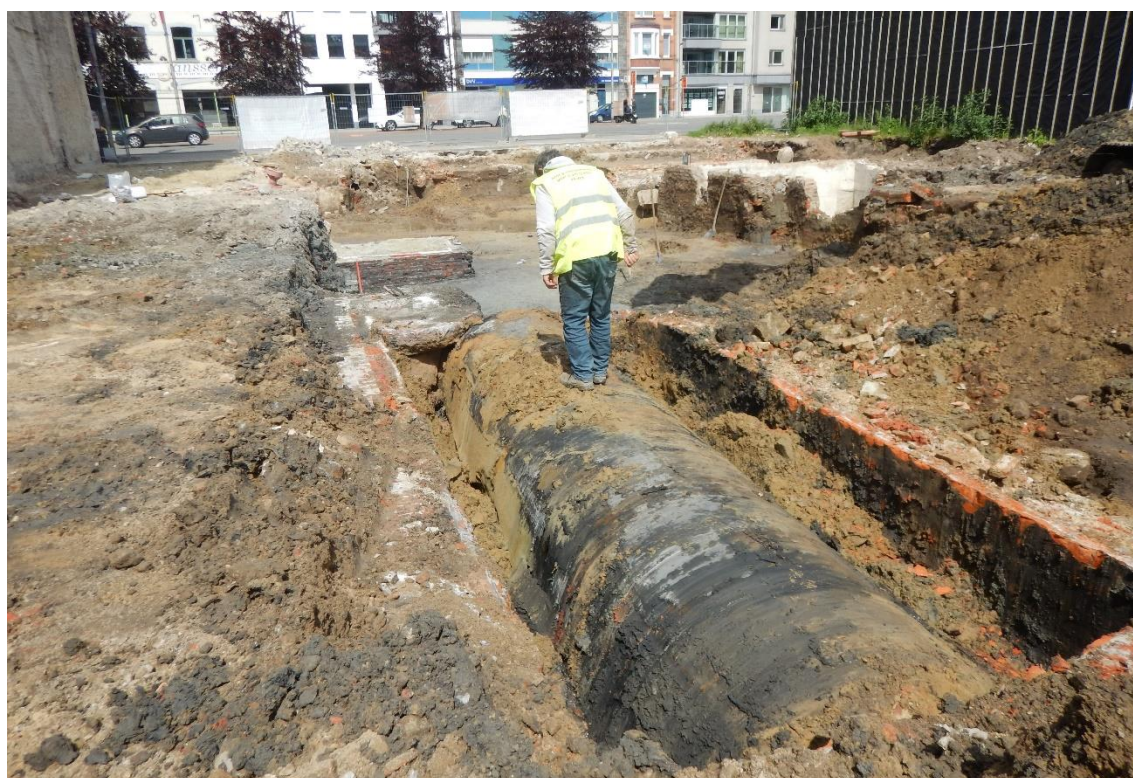
Figuur 8: Grote mazouttank in kelder.
