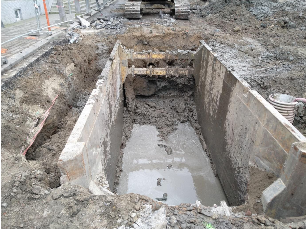
Figuur 7: Zicht op werkput 4 waar een beschoeiing met metalen caisson is geplaatst tegen het inkalven van de sleufwanden.
