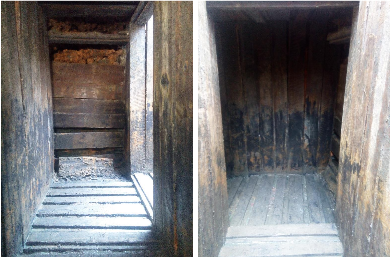
Figuur 25. Zicht op de toegemaakte gang waar oorspronkelijk de derde uitgang had moeten komen met rechts de aanzet van de eigenlijke toegang (linkse foto) en zicht vanuit de eigenlijke toegang naar de gang met rechts de toegemaakte wand (rechtse foto).
