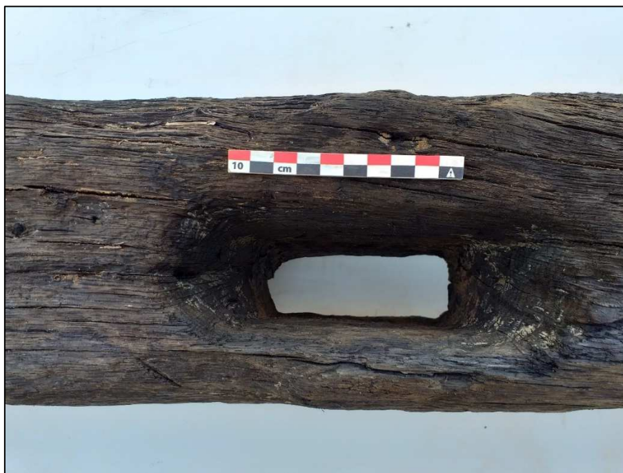
Figuur 34: Detail van gat in balk (Vnr.2).
