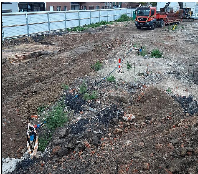
Figuur 6: Elektriciteitskabels langs de oostzijde van het onderzoeksgebied
