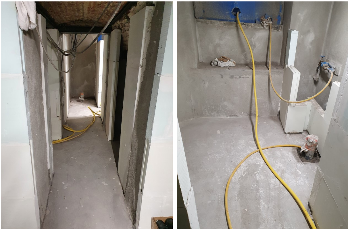
Fig. 12: Toestand van de inpandige kelderverdieping, zoals werd vastgesteld op 04/02/2021.
