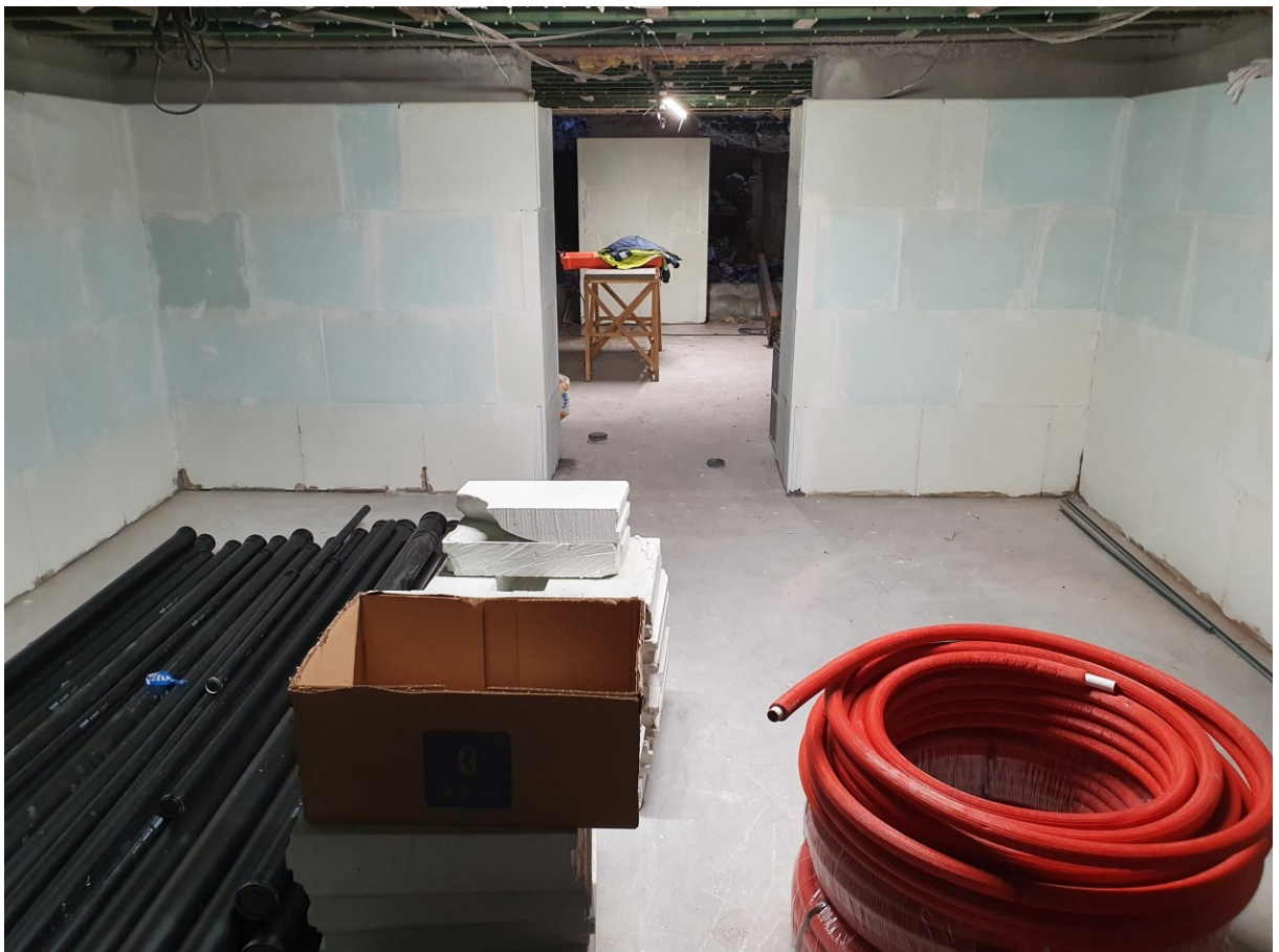
Fig. 10: Toestand van de inpandige kelderverdieping, zoals werd vastgesteld op 04/02/2021.
