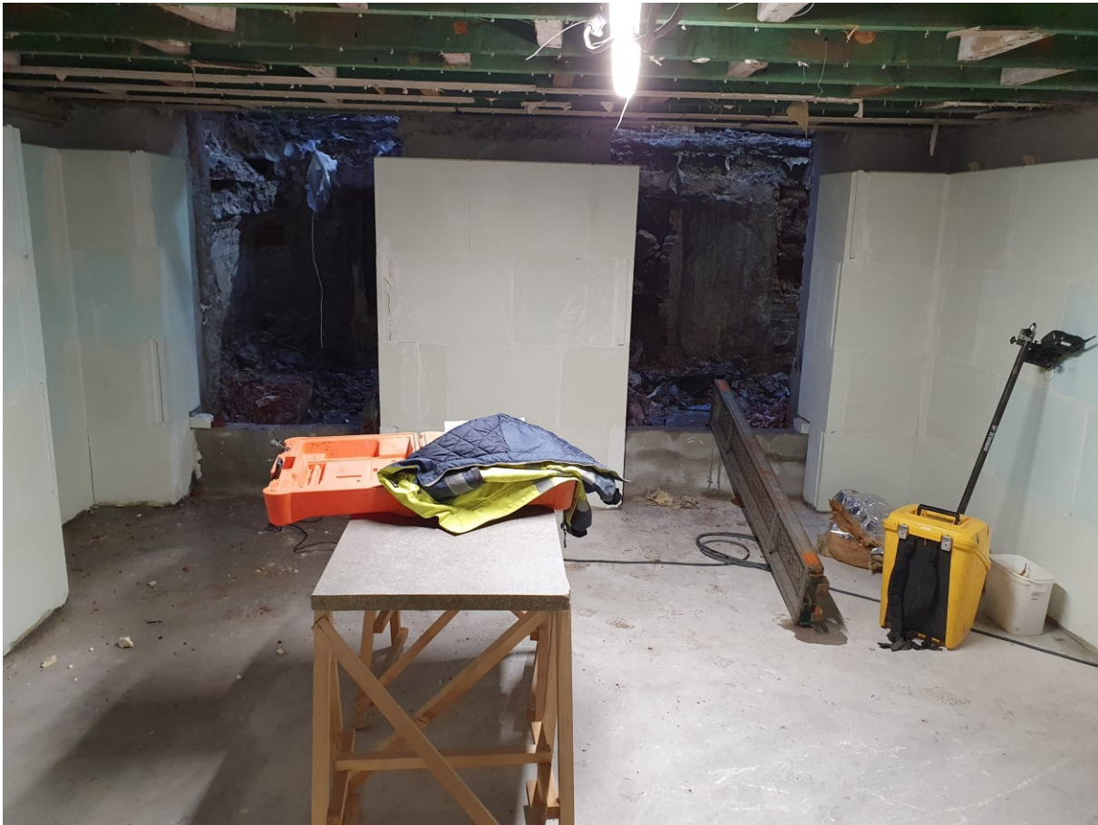
Fig. 11: Toestand van de inpandige kelderverdieping, zoals werd vastgesteld op 04/02/2021.
