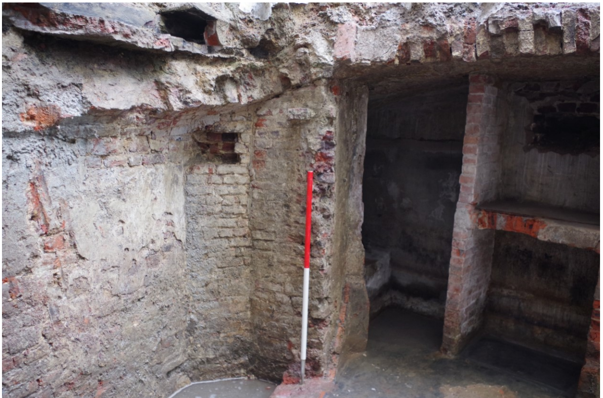
Fig. 19: Links muur S1, rechts S11/S10. Tegen S1 en onder het gewelf werd later (gezien de bouwnaad) S12 en S13 opgemetseld (achter de jalon).
