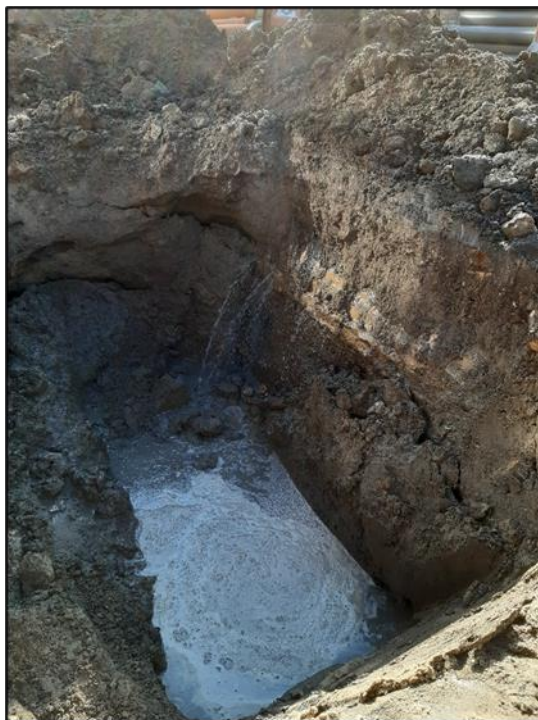
Figuur 2: Insijpelend water uit de scheurende riolering in werkput 1
