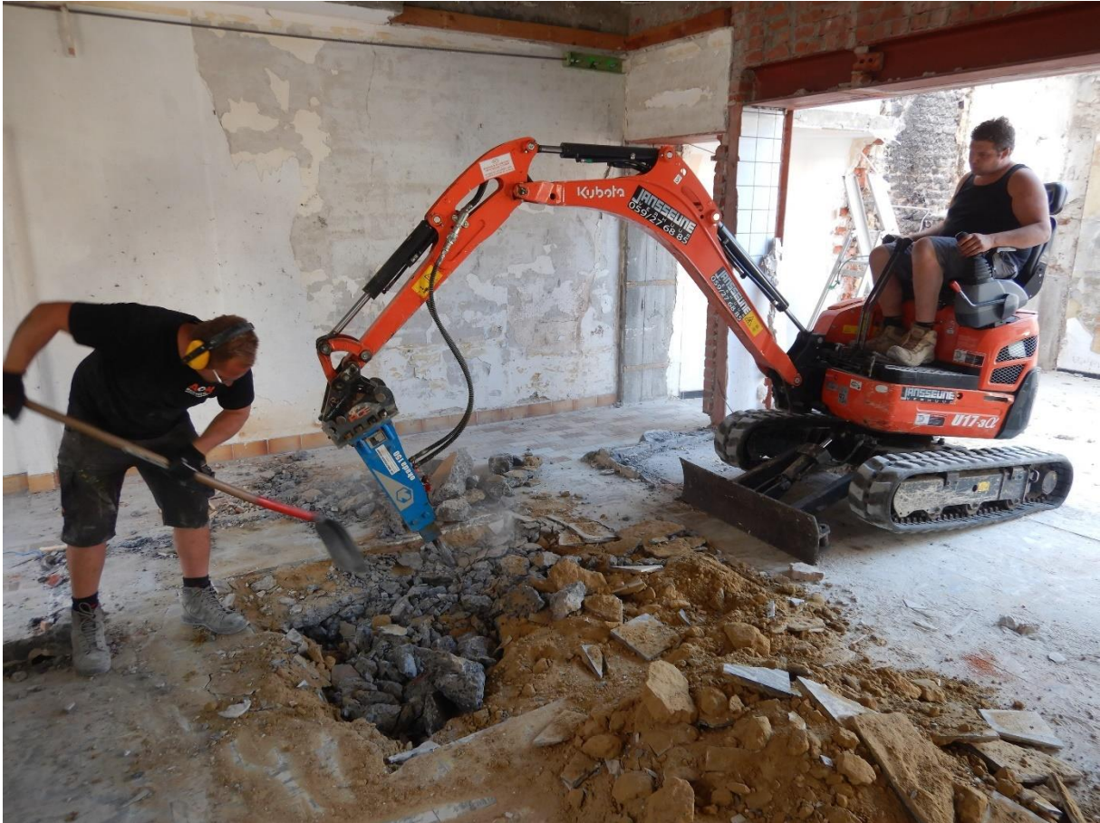
Figuur 12: het uitschieten van de vloer binnenin het huis (WP3 - 22 september 2021)
