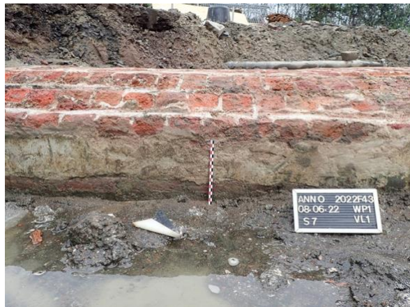
Figuur 30: detail van het pleisterwerk s7 (© Fodio).
