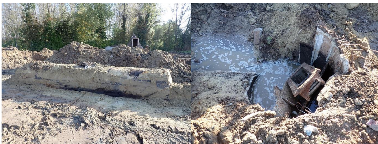
Figuur 67: Zicht op de grote mazouttank en de recente (betonnen) waterput (© J. Verrijckt bv)
