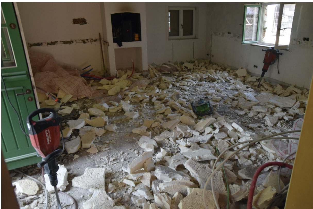
Fig. 3.22: Uitgebroken tegelvloer keuken.
