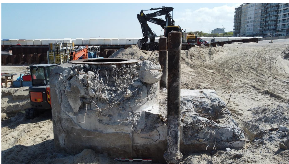
Figuur 39: Overzicht van de schade aan de westzijde van de geschutskoepel.
