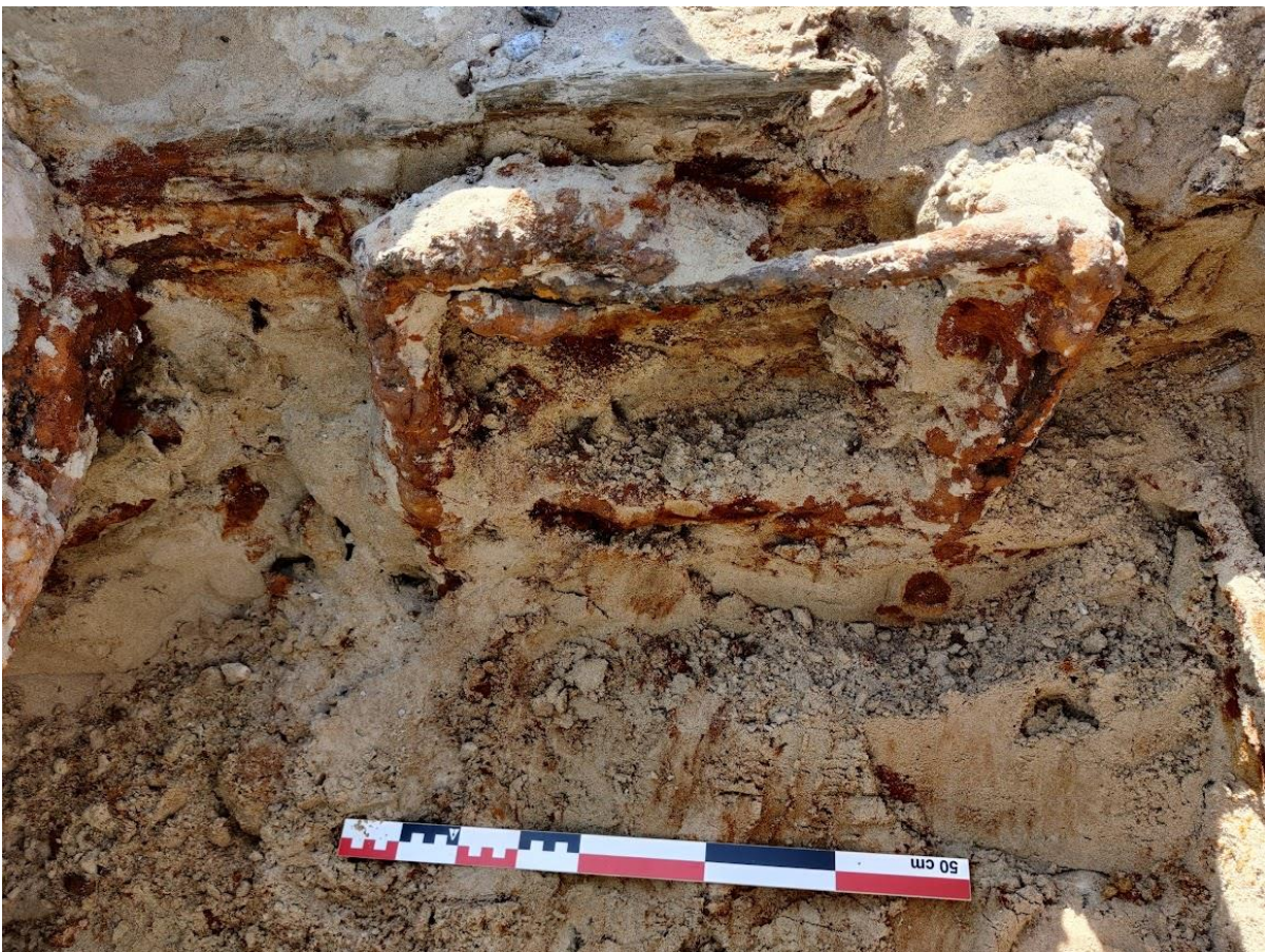
Figuur 41; Veldfoto ingang Belgische bunker: de sterk geoxideerde toegangsladder.
