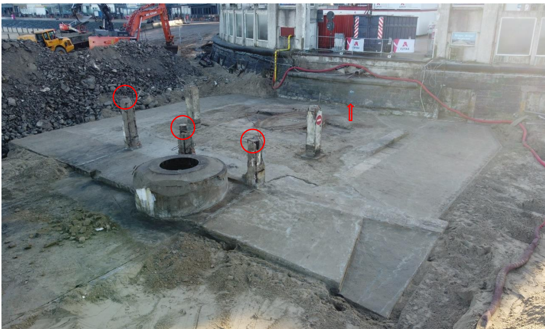
Figuur 17: Overzichtsfoto met restanten van de oorspronkelijke pier uit 1894: (afgebroken) ijzeren kolommen en dijkhoofd (© Raph De Brant).
