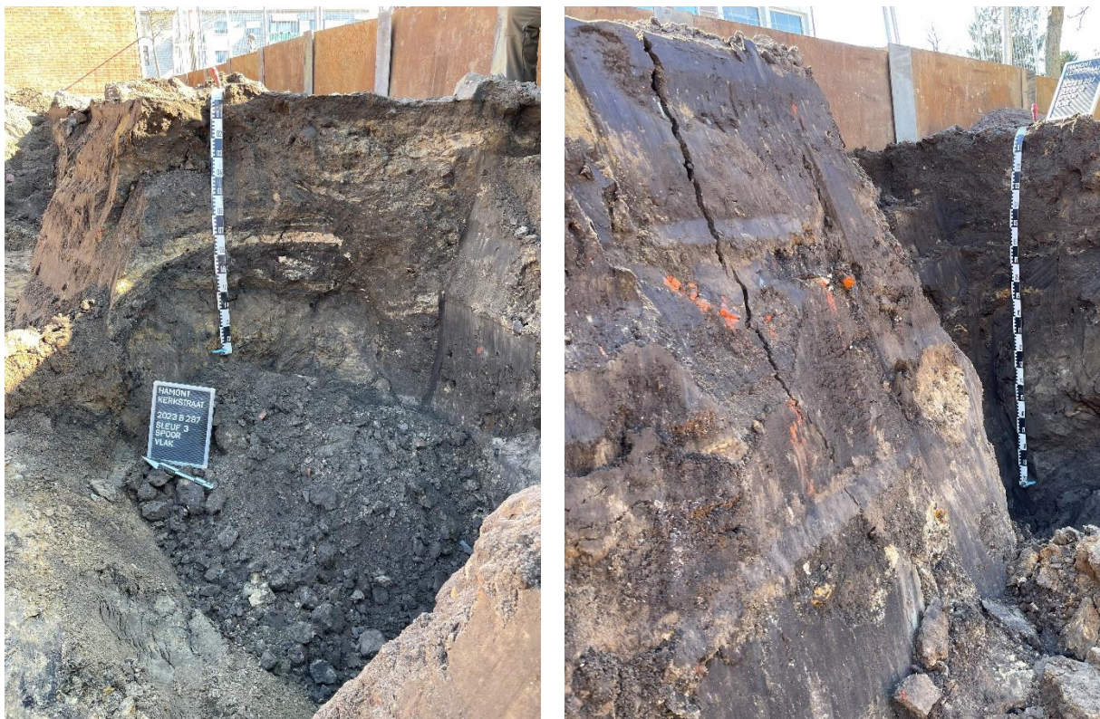
Fig. 23: de oostwand van de profielput “stadsgracht” nadat al een deel ingestort was en de scheur in de opvulgrond aan de oostzijde net voor het instorten van de wand
