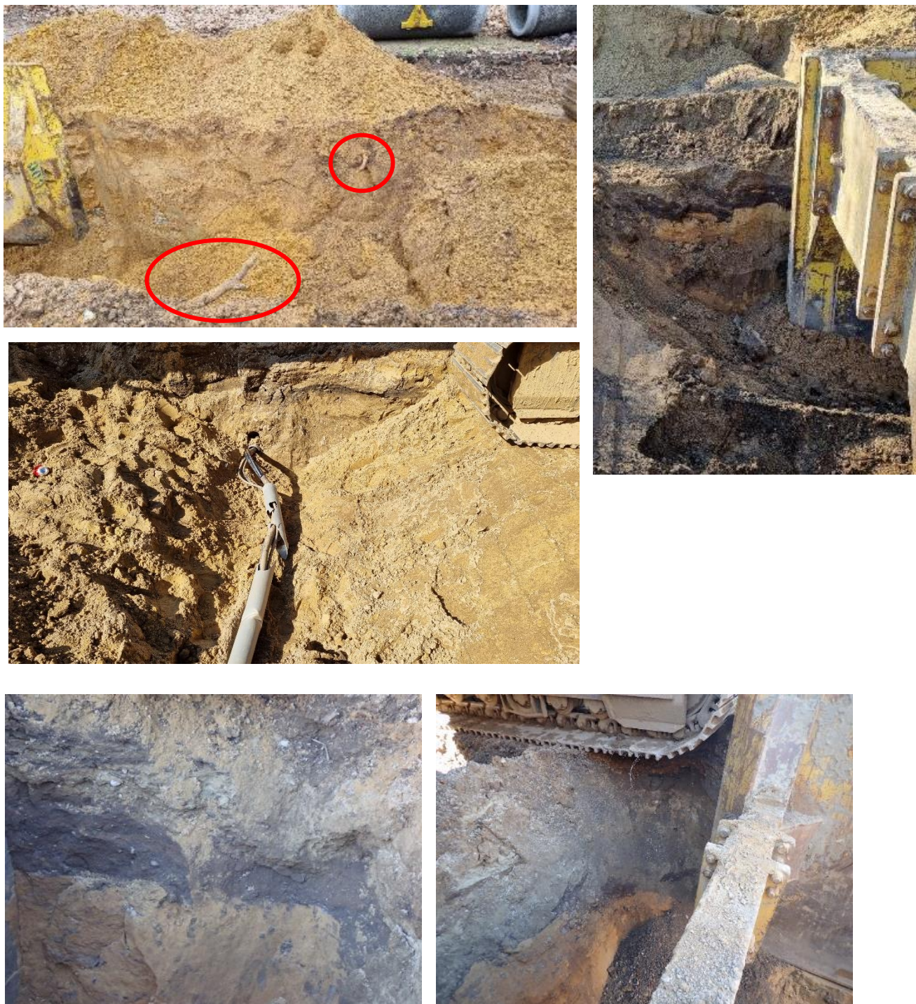
Fig. 13: de restanten van wortels, een elektriciteitskabel en een ophogingslaag/vulling met donkergrijze aarde en steenslag.
