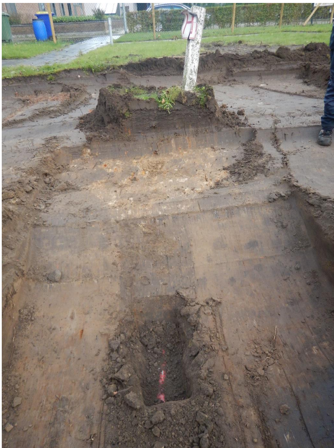
Figuur 25: Detail van een nog werkende leiding binnen het plangebied.
