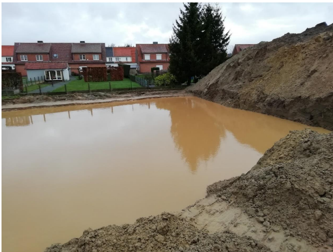
Figuur 12: Veel water in de noordwestelijke hoek van de site (26/02/2020).
