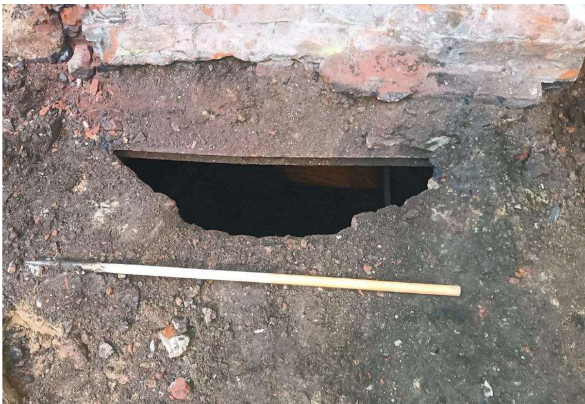
Figuur 61: Toestand van het terrein, fase 2B, grondverzakking in de zuidelijke zone (kijkrichting Z)
