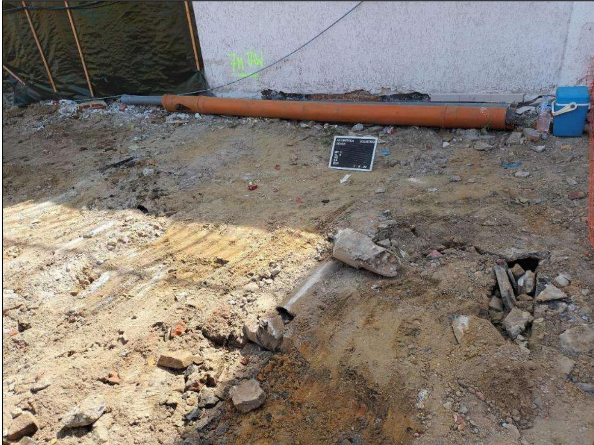
Figuur 150: Werkput 2, recente versterking – asbestbuizen
