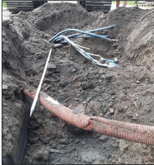
Figuur 3: Zicht op het zuidelijke einde van werkput 2 met twee beschadigde leidingen
