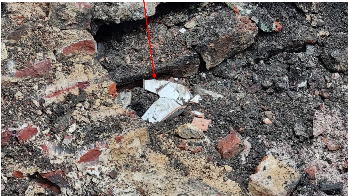
Fig. 20: recent tegelafval in de hoek van opvulling van de trapconstructie
