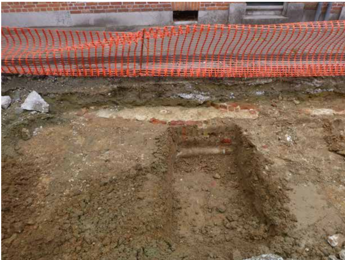
| Figuur 65: Aanwezige leiding tegen S16.
