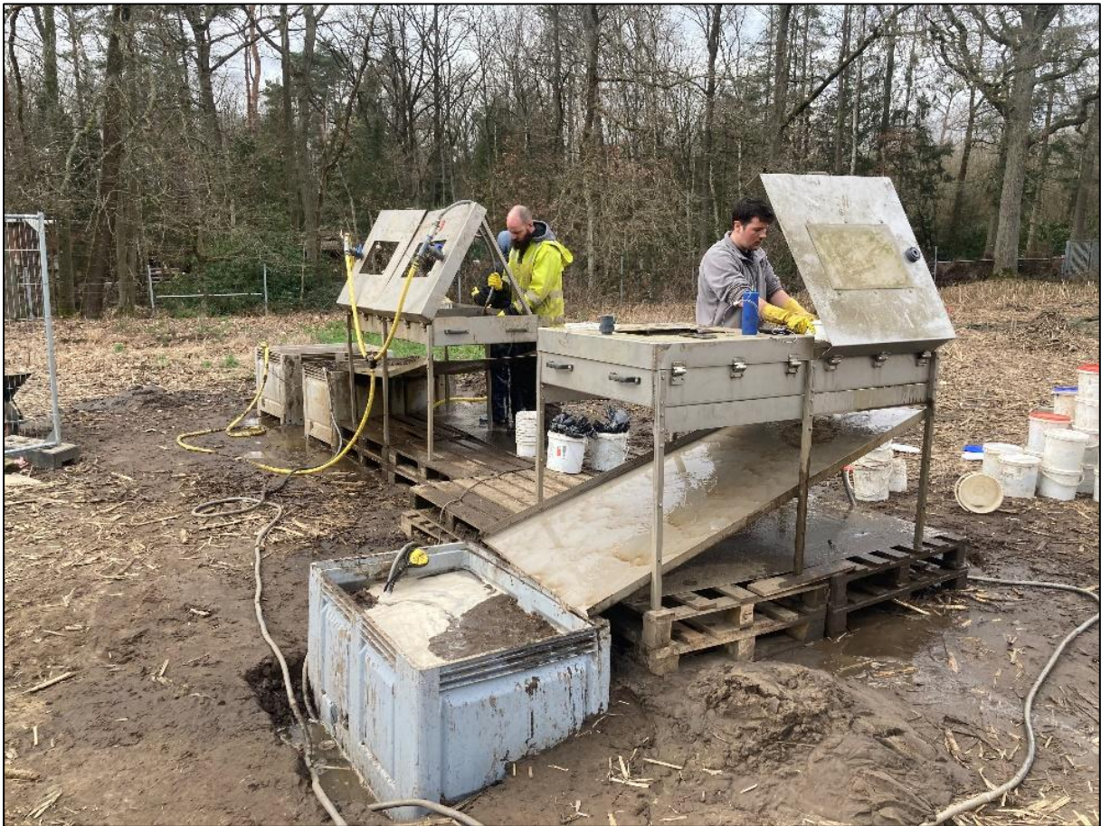
Figuur 18: Zeefinstallatie in gebruik op de site.
