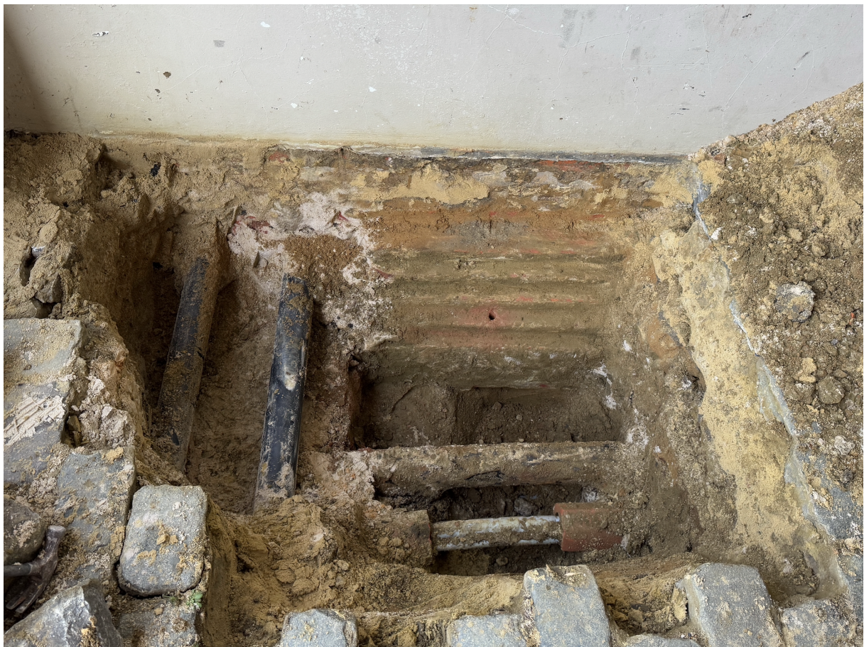
Fig. 2.2: Put 1 tussen de leidingen. Het boorgat in het verstek is een sondering om de dikte van de fundering te controleren.
