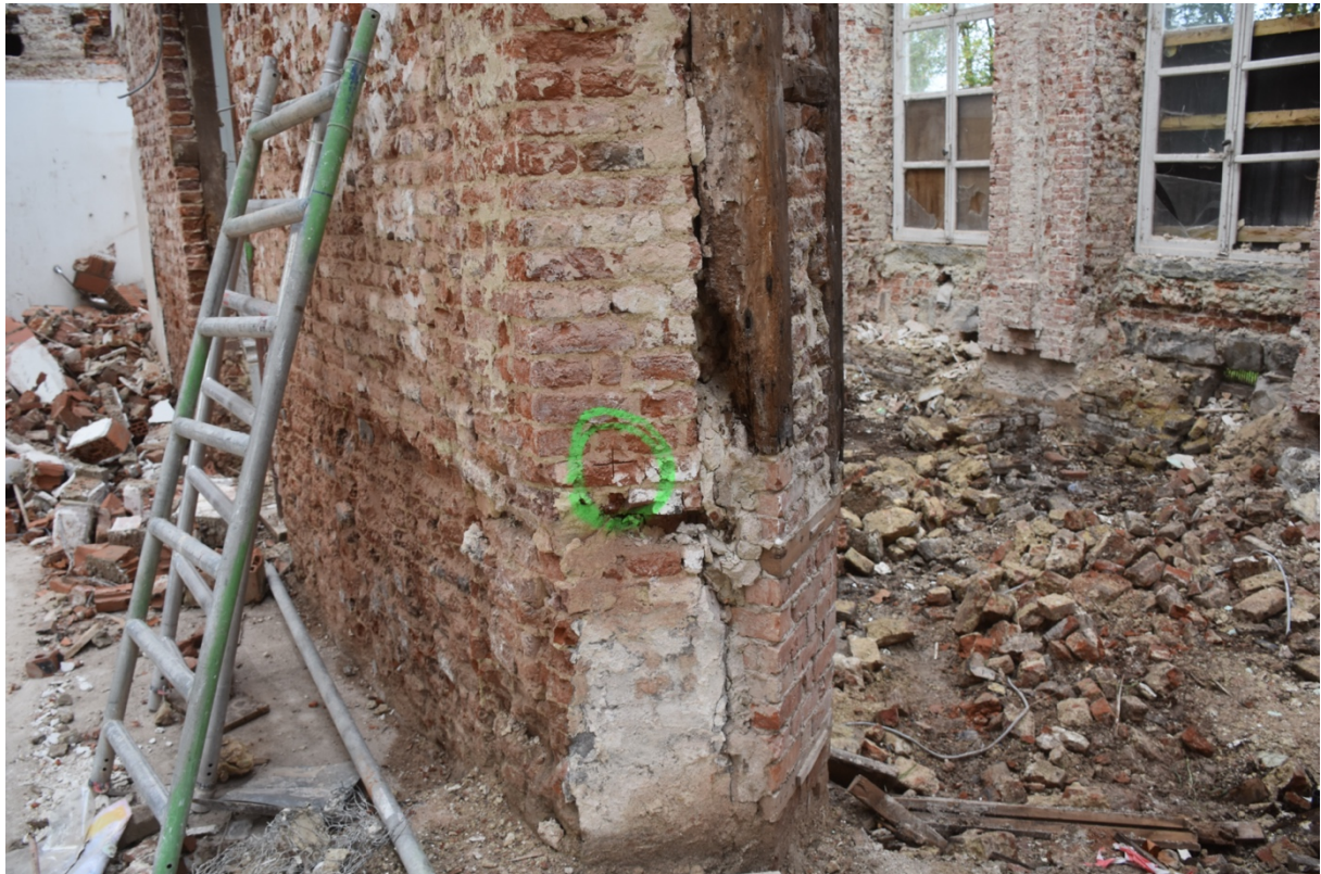
Fig. 3.38: Afgezaagde verrotte houten balken uit 1900 en vervangen door recenter metselwerk en houten balkjes voor de plaatsing van deurscharnieren.
