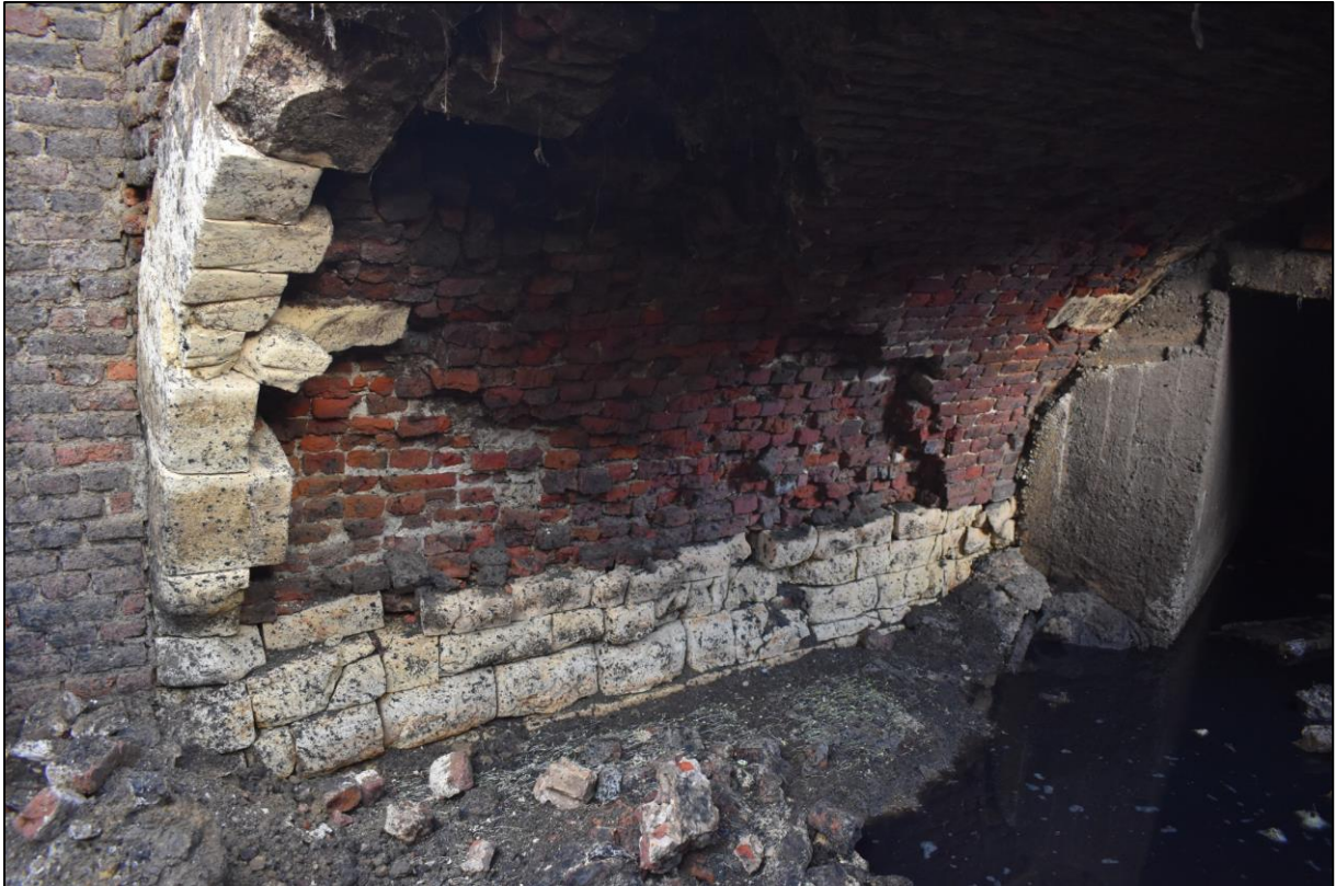
Afb. 51: Binnenzijde van het gewelf van de brug gezien richting het noorden, met rechts de betonnen overkapping van de Nieuwe Demer.
