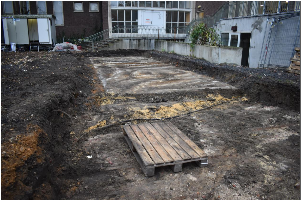
Afb. 49: Bovenzijde van de bekisting van de Nieuwe Demer gezien vanaf de locatie van de brug richting het westen.
