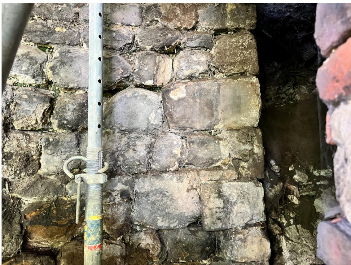
Figuur 79: Zicht op het muurwerk binnen de kern van de opening, enkel bestaande uit natuursteen.
