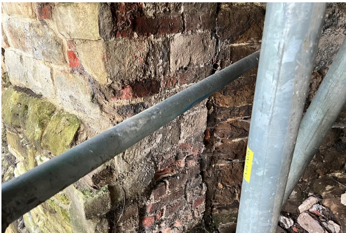
Figuur 77: Zicht op de westelijke zijde ingang met duidelijke bouwnaad tussen facade (baksteen en natuursteen) en kern (enkel natuursteen).
