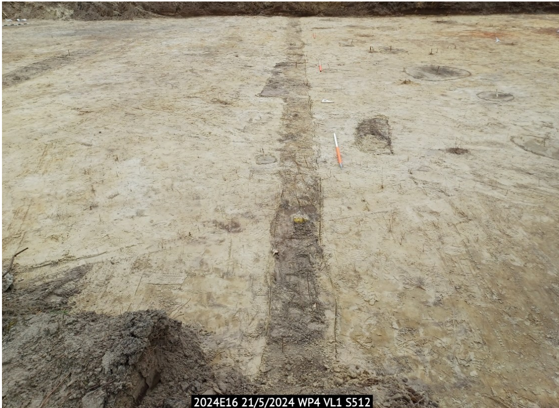
Figuur 77: Verstoring S512 van een middenspanningskabel in het vlak
