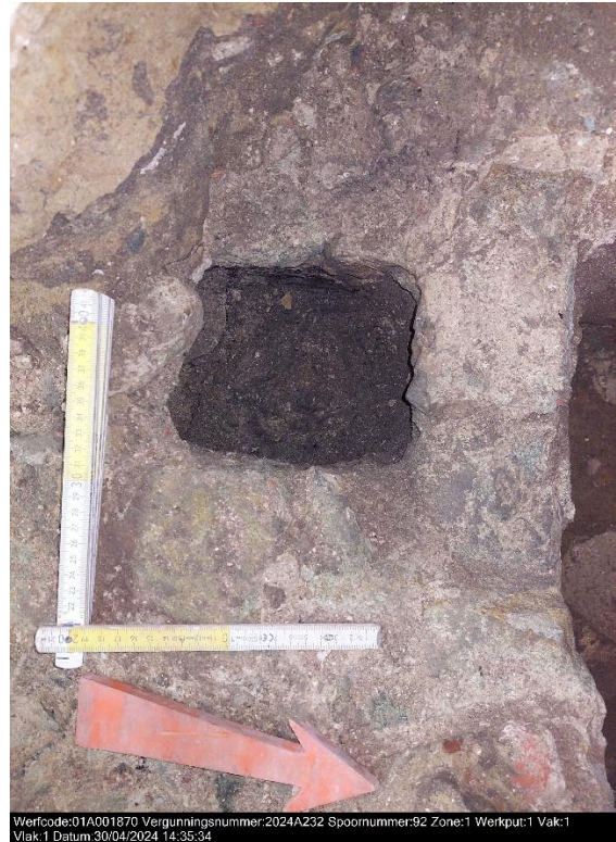
Figuur 76: Detailzicht op het gat in muur S89.
