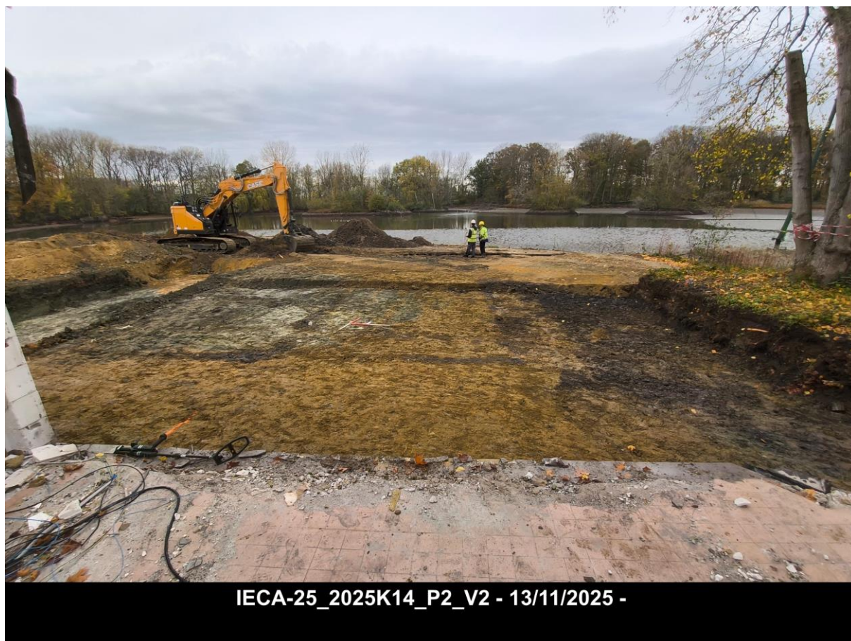
Figuur 14: Overzicht put 2 met zicht op de verschillende vlakken ( vanuit zuiden)
