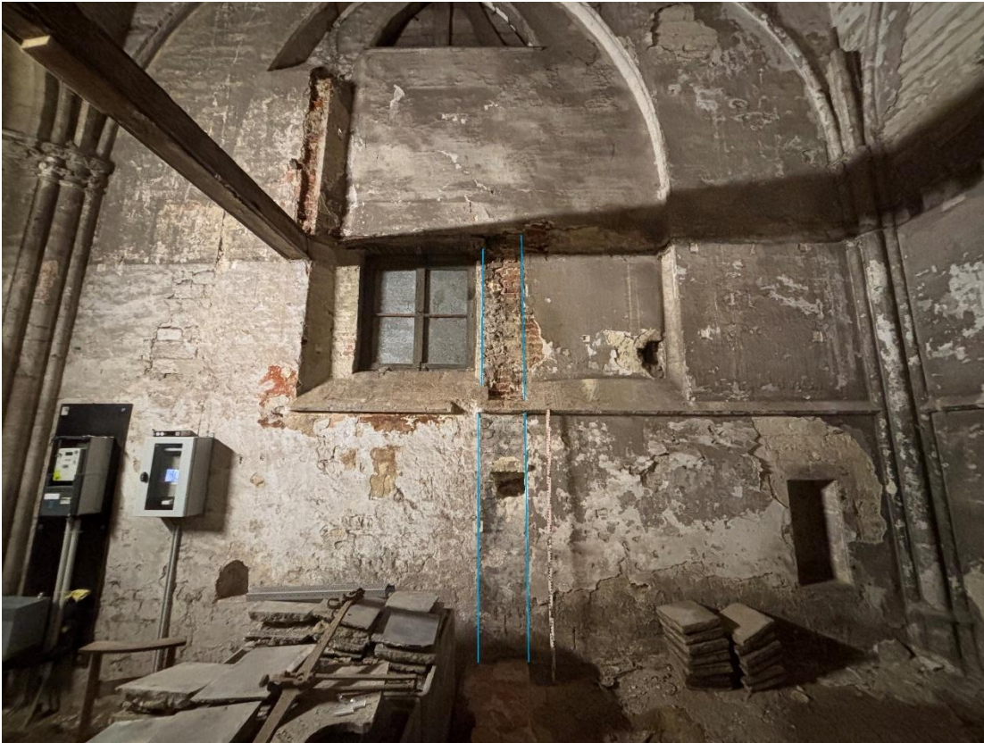
Figuur 64: Afdruk van opgaand deel van S19 op de zuidelijke buitenmuur van de kerk, met dichtgemetseld gotisch raam.
