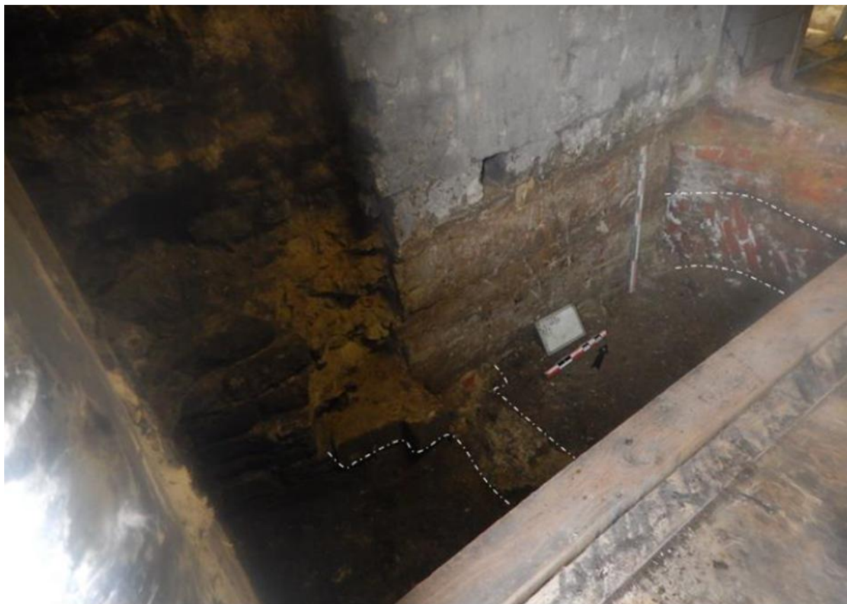
Figuur 6: WP4 West: met in het oosten de spaarboog van het lage muurtje en centraal de funderingen van de traptoren (© Monument Vandekerkhove).
