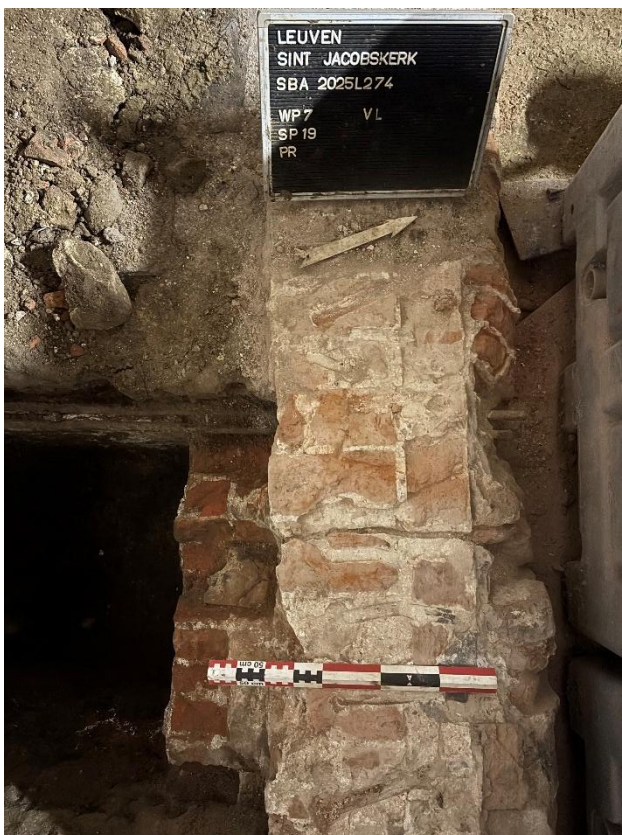
Figuur 55: bovenaanzicht van S19 ter hoogte van WP7 (links op de foto).
