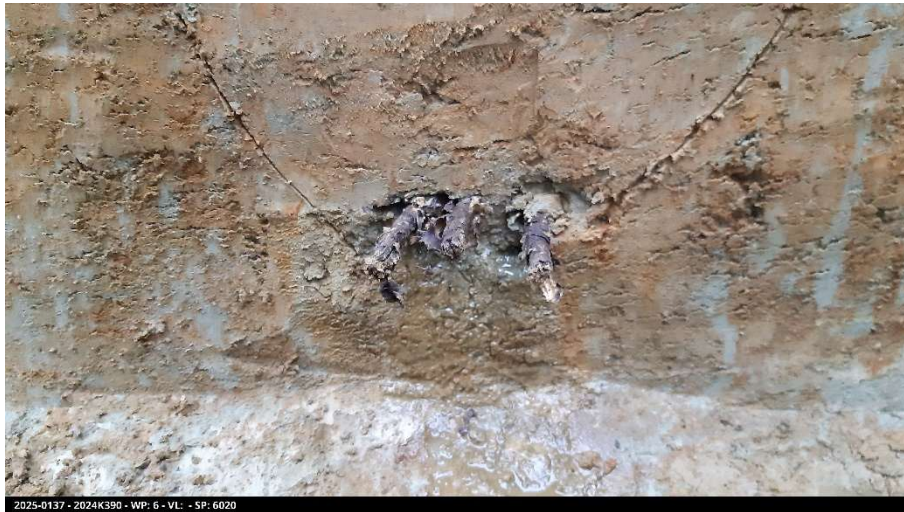
Figuur 100: Detailfoto kabels onderaan de communicatielijn
